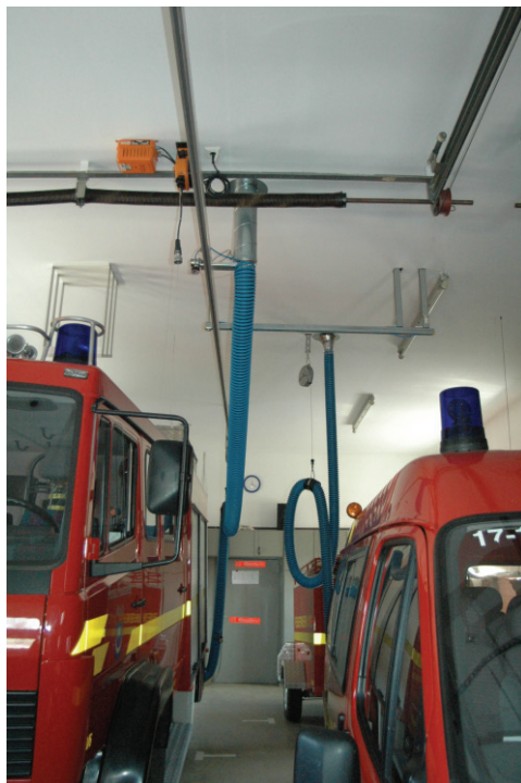
Abb. 7.21 Fahrzeughalle Feuerwehrgerätehaus Ahmenhorst mit Abgasabsauganlage
