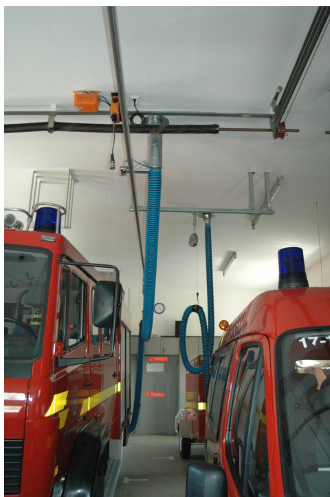
Abb. 7.21 Fahrzeughalle Feuerwehrgerätehaus Ahmenhorst mit Abgasabsauganlage
