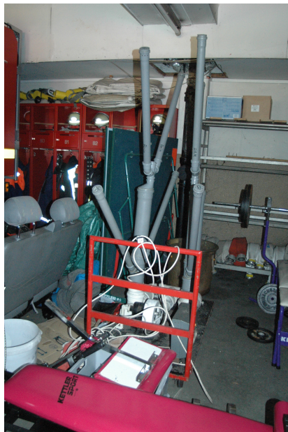
Abb.7.4: Trocknungsanlage für CSA der Feuerwehr
