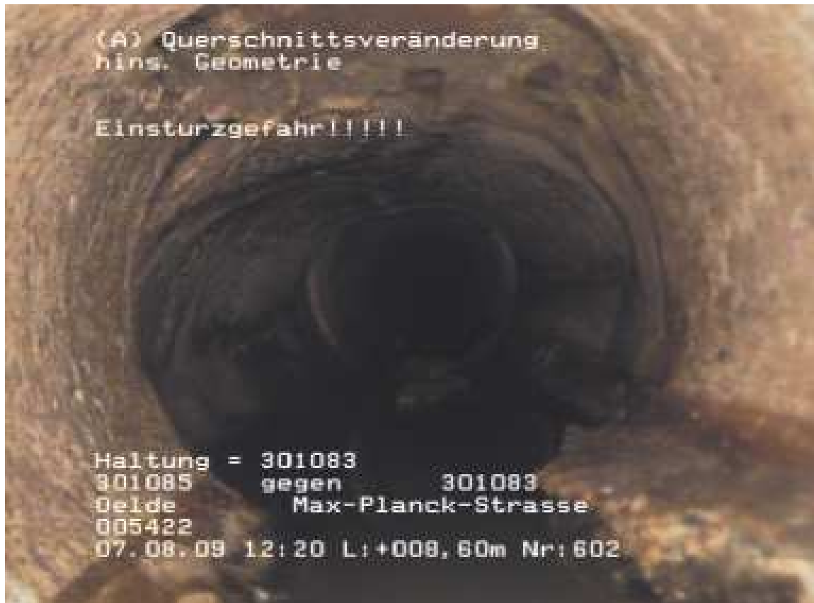
Profilverlust mit Einsturzgefahr
