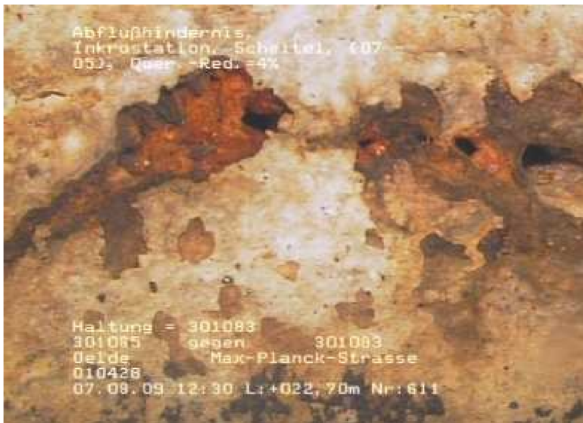
Inkrustation und Korrosion - Undichtigkeiten
