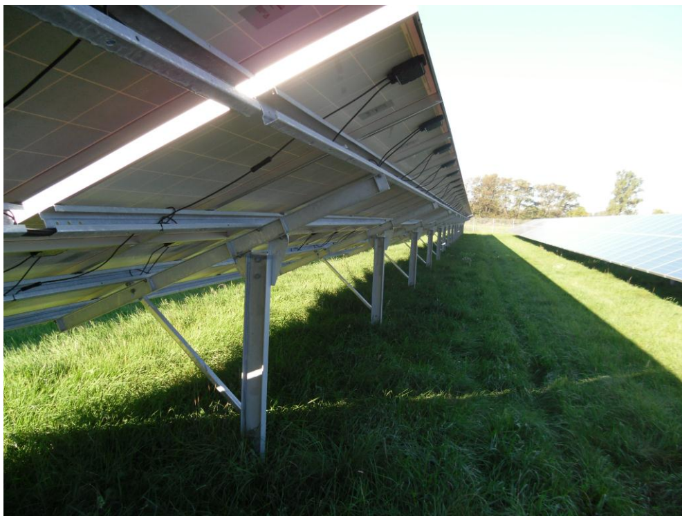
Beispielhaftes Foto der vorgesehenen Modultische (Quelle: Hilker Solar GmbH, Rahden in Westfalen, März 2013)
