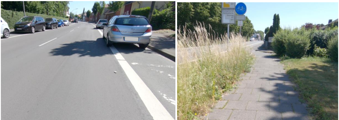
Abbildung 24: Oelde, L792 Ennigerloher Straße, keine geeignete Radverkehrsanlagen vorhanden
