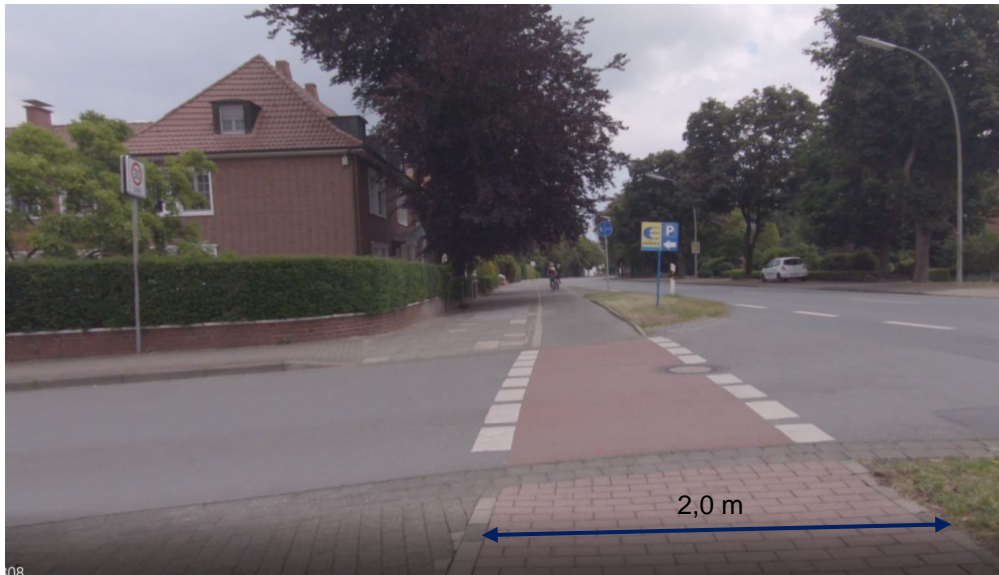
Abbildung 37: Stromberg, L586 Oelder Tor, Mindestmaße für Zweirichtungsweg nicht eingehalten
