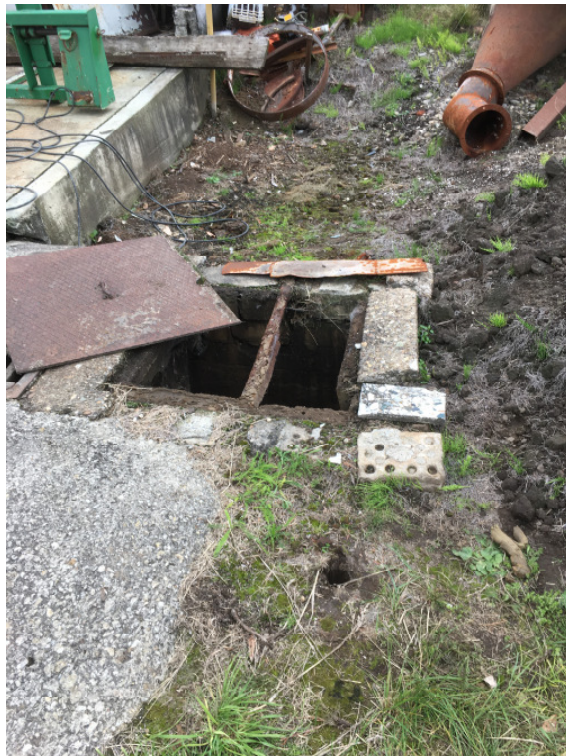
Foto: Sickerschacht im Hof, Sondierung RKS 2
