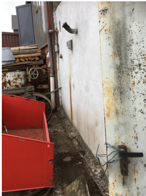
Foto, Heizöleinfüllstutzen, RKS 3
