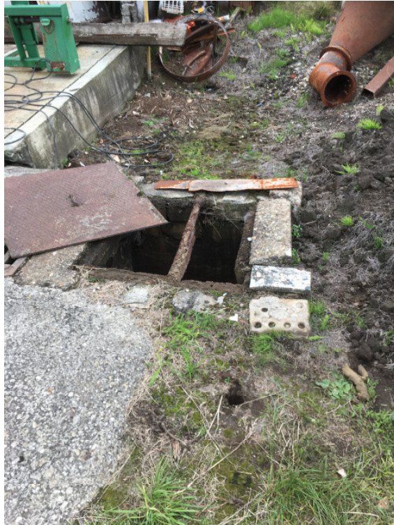
Foto: Sickerschacht im Hof, Sondierung RKS 2
