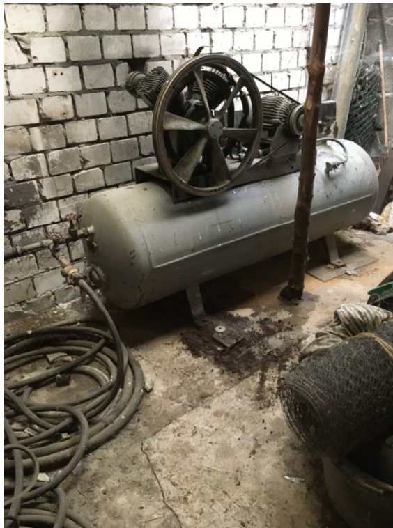
Foto: Kompressor, Sondierung RKS 5
