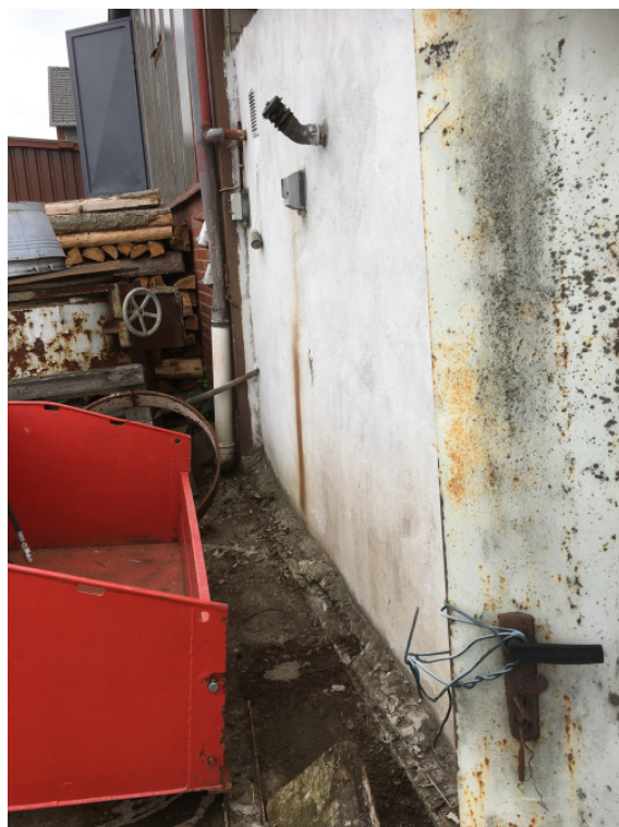
Foto, Heizöleinfüllstutzen, RKS 3
