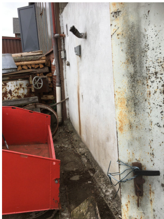
Foto, Heizöleinfüllstutzen, RKS 3
