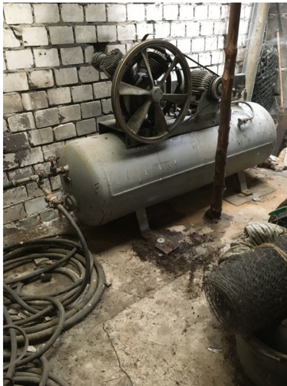
Foto: Kompressor, Sondierung RKS 5
