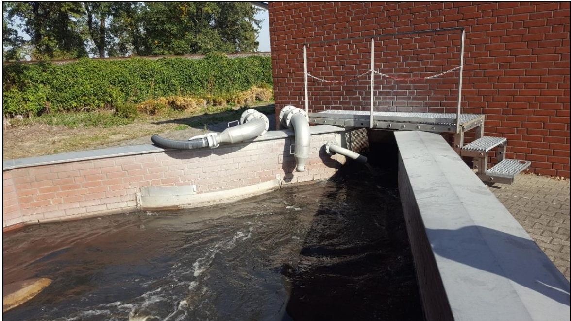
Abbildung 25: Einlaufsituation Kläranlage, Zulaufgerinne hinter den Einlaufschnecken – Anbindung der bestehenden Druckrohrleitung über die seitliche Gerinnewand
