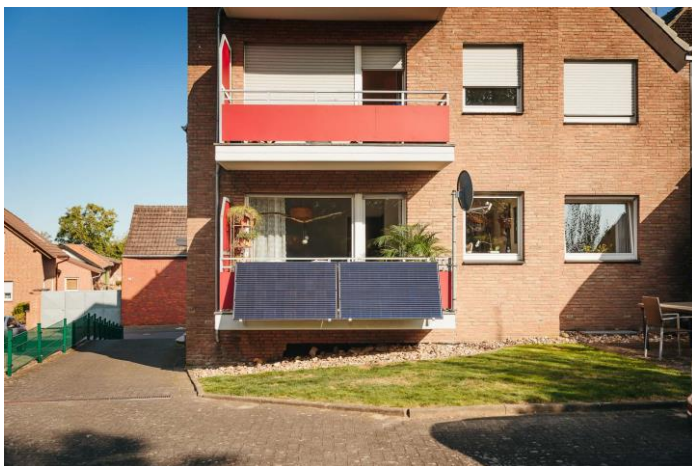
Abbildung: Stecker-PV-Anlage am Balkon (Yuma Balcony Eco Set)
