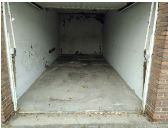
Foto 5: Garage (keine Grube vorhanden)
