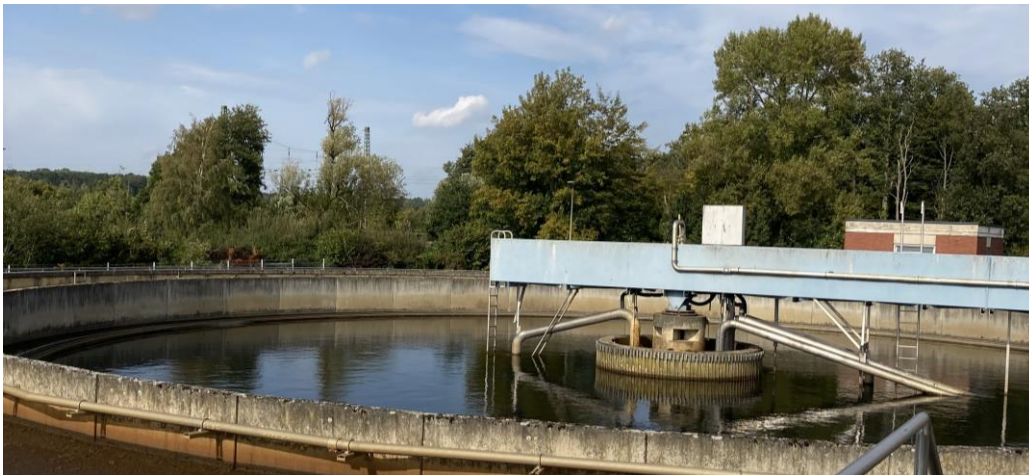
Abb. 8 : Nachklärbecken ½ KA Oelde mit jeweils A = 695 \text{ m}^3 Oberfläche
