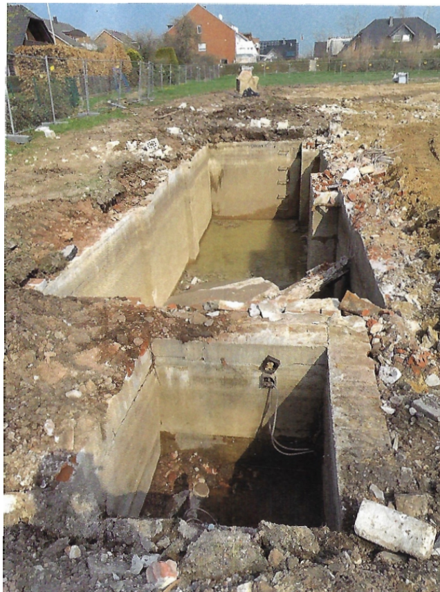
Foto 20: Ansicht auf die rechteckigen Gruben nach dem Leerpumpen.
