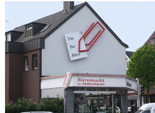
Beispiel einer Gebäudeabschlusswand mit mangelhafter Gestaltung
