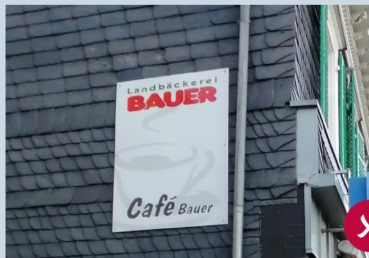
großformatiges Hinweisschild ohne Abstimmung auf die Fassade
